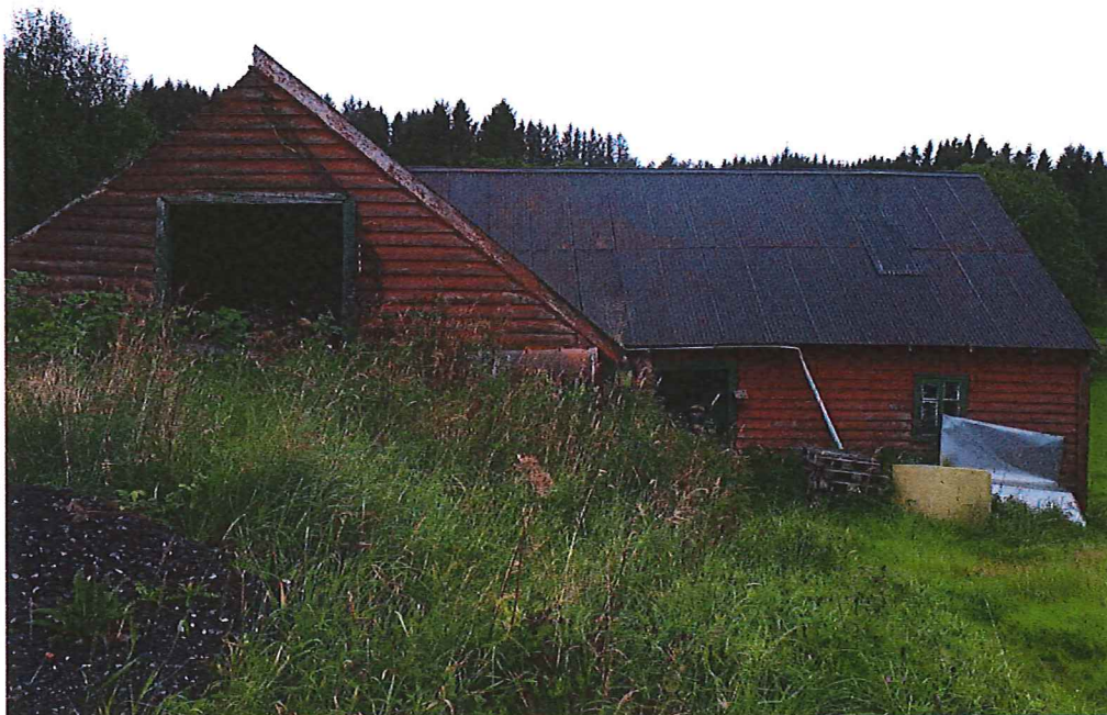
Bilde nr 1: Her ser man at deler av tak falt sammen, og løen er i generelt dårlig forfatning.
