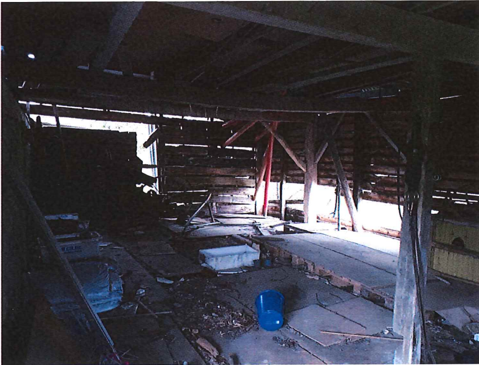
Bilde nr 5: Bilde tatt fra innsiden av løen.
