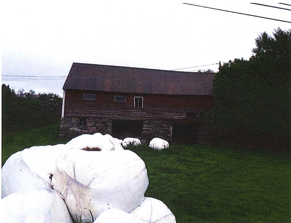
Bilde nr 3: Viser løens dårlige forfatning.
