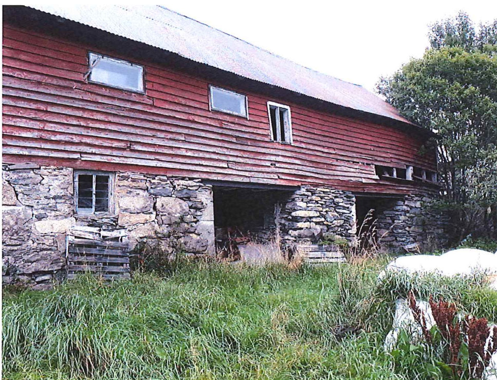
Bilde nr 4: Fasaden har flere hull i kledning, og bærer sterkt preg av forfall.
