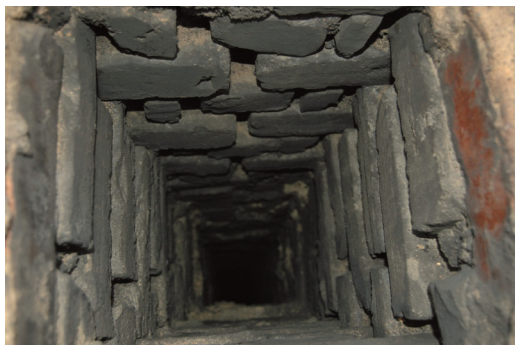
Fig. 26 Eksempel på røykkanal med manglende mørtel i fugene på grunn av forvitring. Foto: Roar Gulbrandsen
