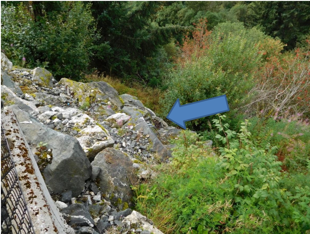
Fig.8: Fylling i foten av 28 B. Fyllingen ligger an mot en flate i terrenget. Vist med pil. Man er usikker på om denne fyllingen vil holde seg stabil over tid.
