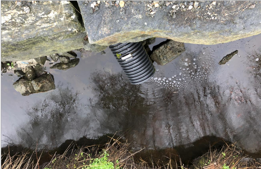
Figur 23. Eit av fleire røyr med utslepp av vatn frå næringsområdet til bekken.
