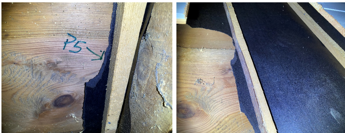
Figur 16: Det er ikke påvist asbest i takpapp
