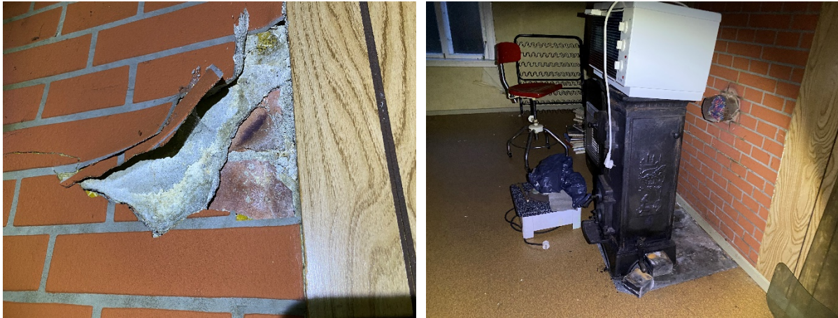
Figur 17: Det er ikke påvist asbest i tapet bak peisen
