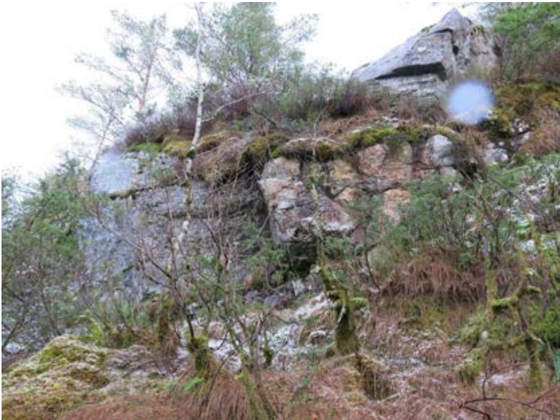
Bilde 4. Potensielt løsnemråde for steinsprang, nordøst for planområdet. Se faresonekart for potensielt utløpsområde. Bilde tatt mot øst.
