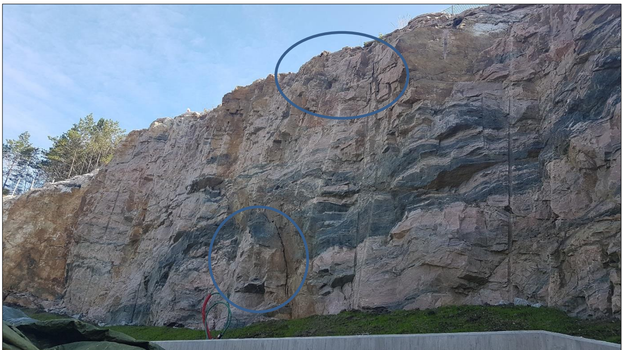
Figur 6: Skjeringa i området mellom bustadblokk B og C er kring 7 m høg, og avstanden til betongmuren er ca. 1,5 – 2,0 m. Det er identifisert delvis avløyste blokker i både nedre og øvre del av skjeringa i dette området (blått omriss).
