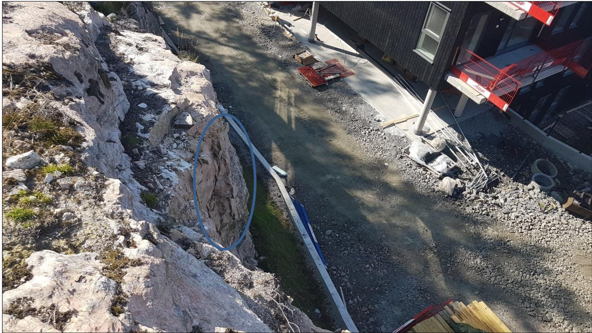
Figur 7: Same området som Figur 6 sett ovanfor. Vertikale sprekker i øvre del gjer at det er fare for utrasing av blokker som har potensiale til å endre retning og nå over gjerdet. Blått omriss markerer ei delvis avløyst blokk.
