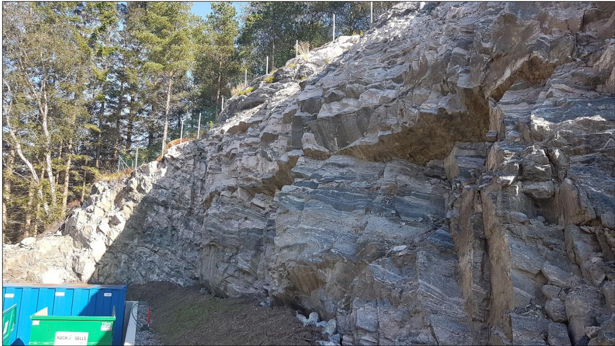
Figur 3: Skjeringa frå nordlege del og til der den svingar austover. Overflata er mest oppsprokke i nordlege del, men det er fare for utfall av større blokker i sørlege del. Biletet er tatt mot nord.
