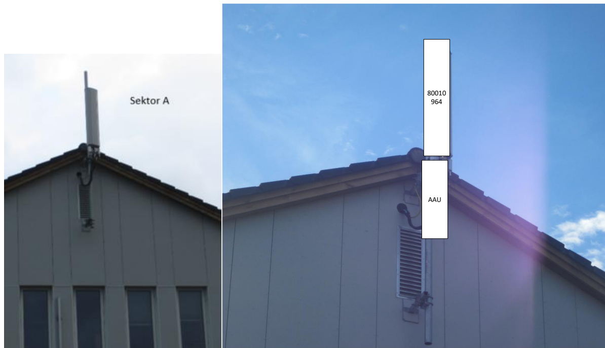
Figur 3: En eksisterende antenne (t.v) demonteres og to nye monteres (illustrert t.h) Dimensjon nye antenner h/b/d 1499/508/175 mm (80010964) og 699/395/160 mm (AAU5339w).
