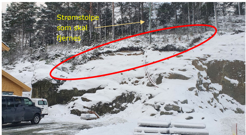
Figur 10 Løsmasser langs topp skjæringskant ved strømstolpe.
