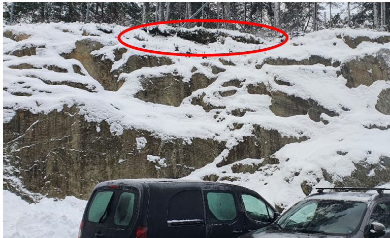
Figur 4 Undergravde løsmasser på topp skjæringskant over parkeringsplassen.
