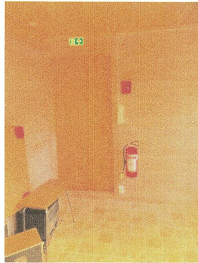
Håndslukker på loft mellom branncellene. Nøkkelboks. Ledelys over dør.
