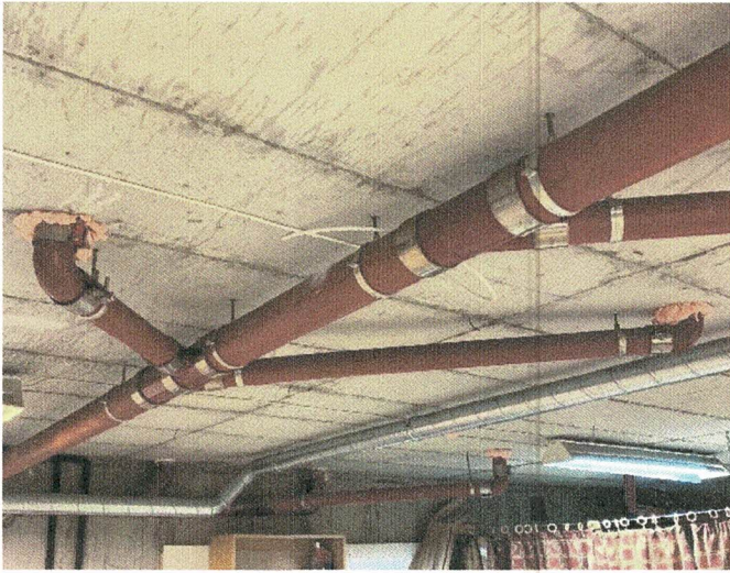
Brann tetting rundt rørgjennomføring i betongdekke
