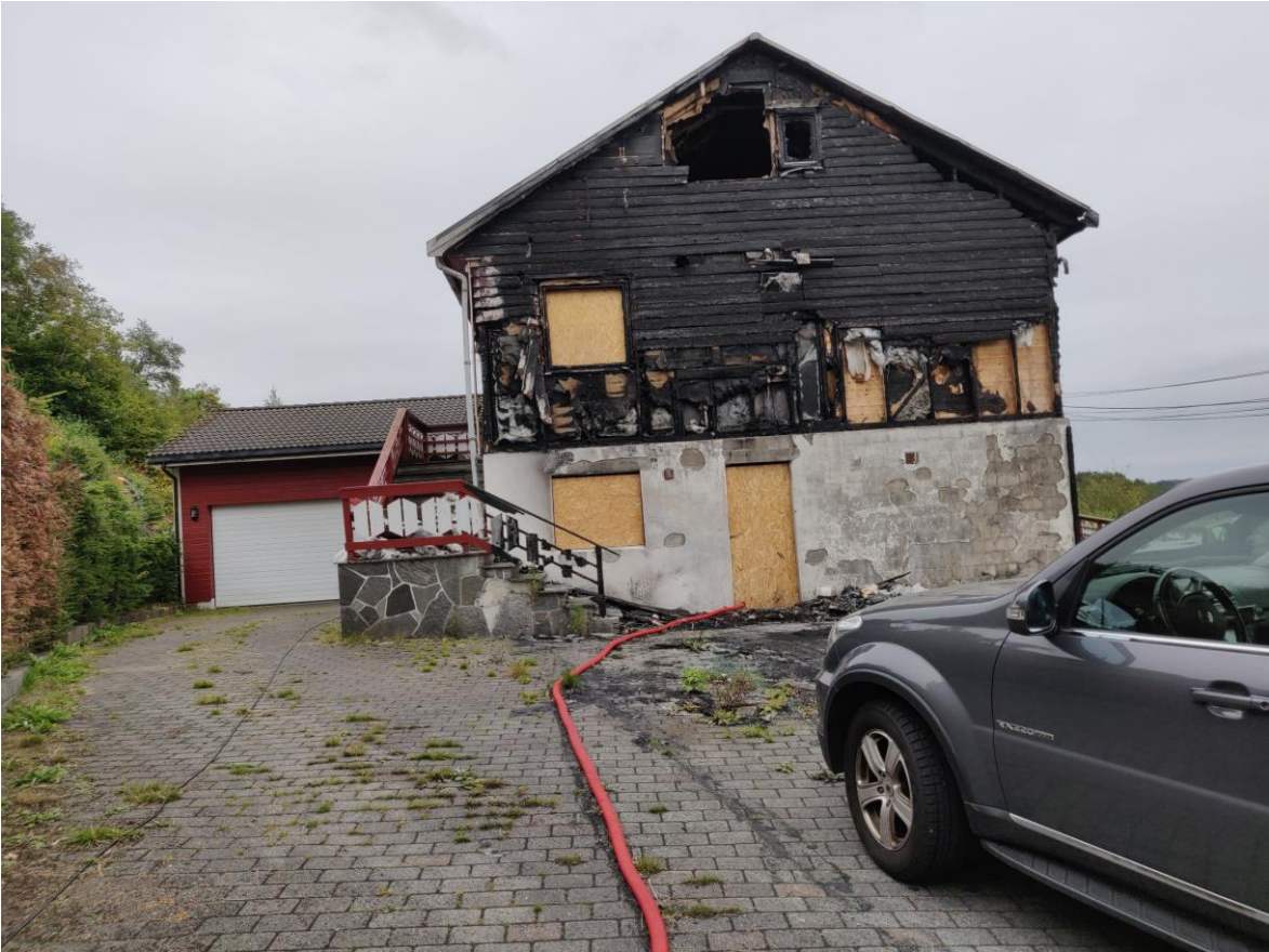
BILDER AV BRANNSKADET BOLIG.
