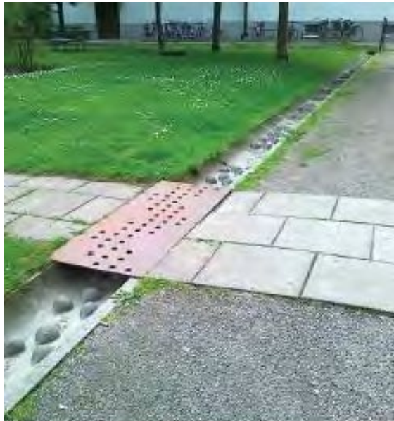
Figur 9, åpen renne for å lede overvatn.
