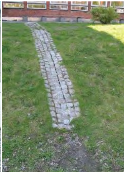
Figur 10, åpen renne for å lede overvatn.
