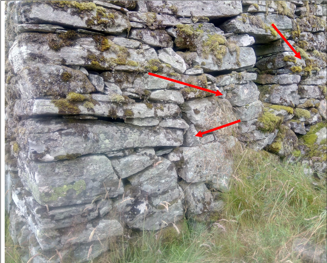
Spalter som tyder på at det har vore endringar i muren sidan førre synfaring.
