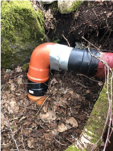
Bilde 1 før utbedring.
