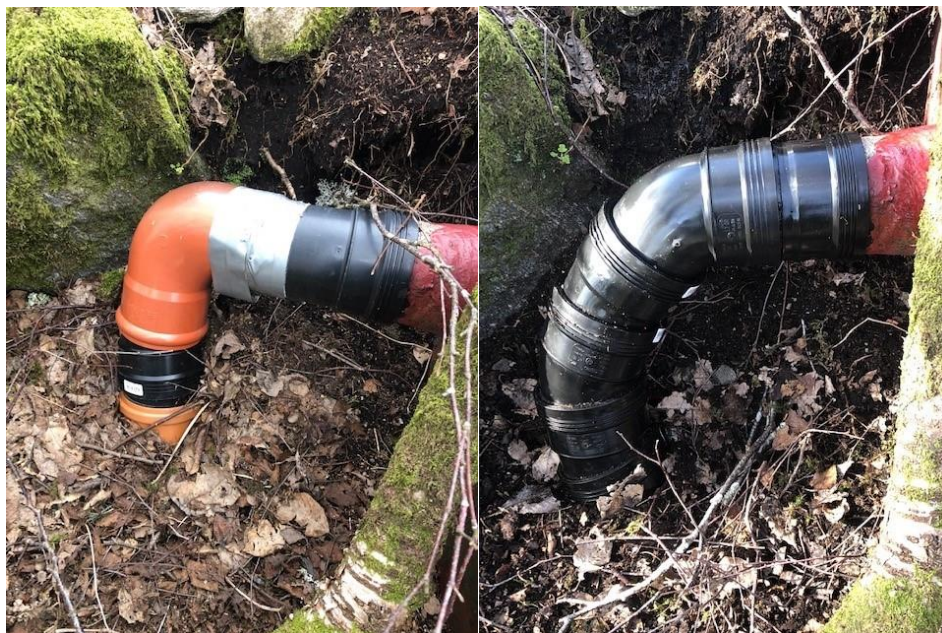
Bilde 1 før utbedring.
