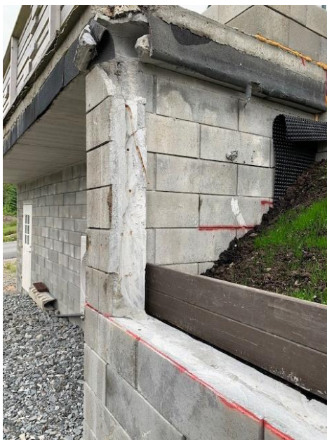
Bilde 2 som viser deler av gjenstående ulovlig mur. Hvor i rammeløyver er det dokumentasjon på at denne ulovlige muren kan stå igjen?
