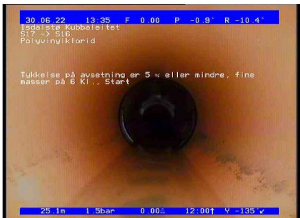
_S17_S16_30062022_012629_007.jpg, 00:04:58, 25.17 Tykkelse på avsetning er 5 % eller mindre, fine masser på 6 Kl., Start / i innløp til kum S16
