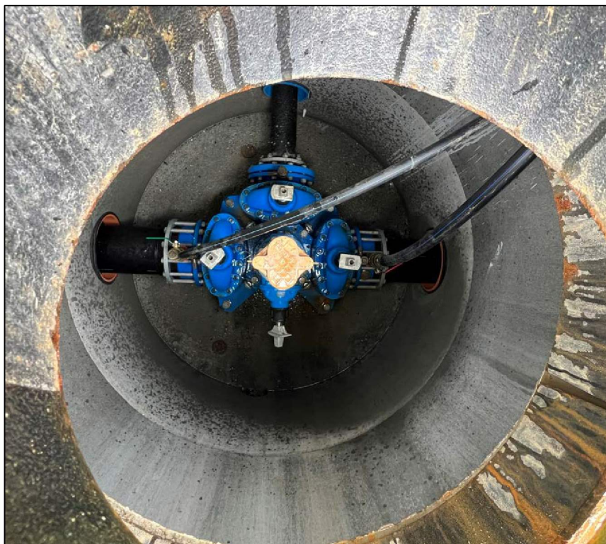
Bilde 1 - Eksisterende brannvannskum SID 44340
