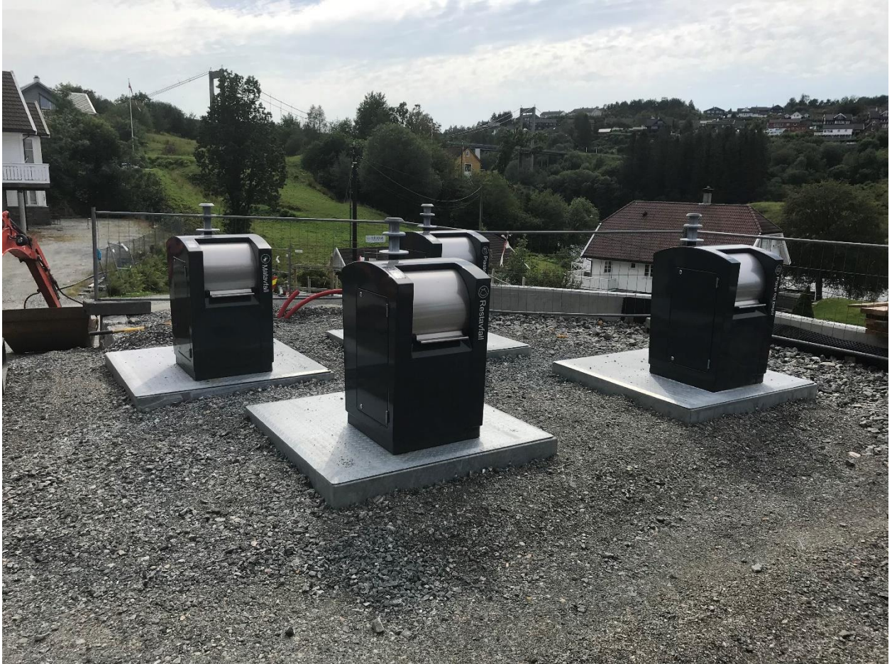
Figur 1: Døme på nedgravne konteinarar frå Alver brygge 26.07.2019 etter montering, men før ferdigstilling.
