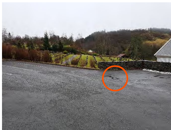
Figur 9: Sluk som er gått tett, plassering på P-plass ved kyrkjestova. Sluk vist med raud sirkel.
