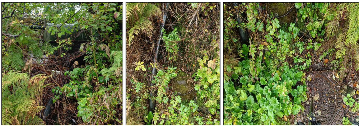
Figur 2 Septiktank kan sees i venstre bildet, med tilhørende spillvannsledning i midten og øvre venstre del av høyre bildet.
