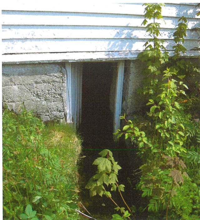
Vannet står 1/3 opp i kjeller
