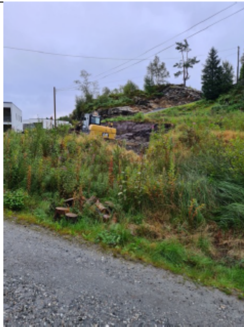
Bilde viser pågående gravearbeid på et mindre område sør for B5. Kloppedalsbekken er lagt i rør under dette området.
