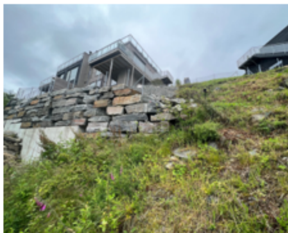
Mur på gbnr. 323/622.
