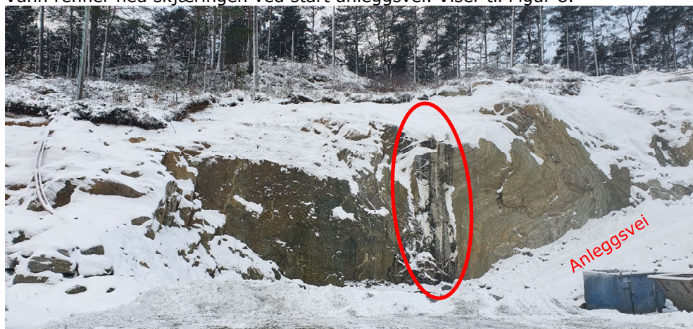
Figur 8 Vann renner ned langs skjæringen bak planlagt nybygg.
