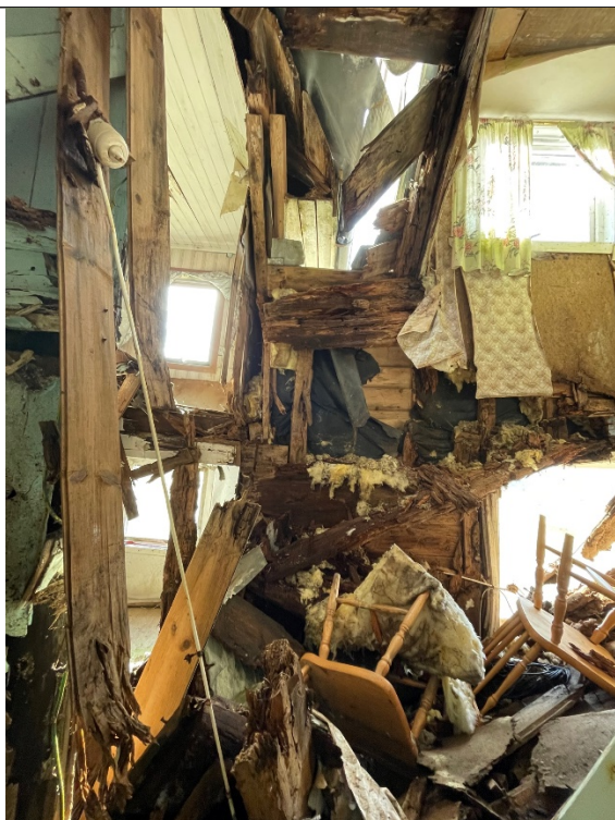
Stue nord – sett mot vest. Foto viser sikt mot 2 vinduer til venstre. Det er kjøkkenvindu og vinduet over – begge mot vest. De kan sees fordi både vegg mot kjøkken, og gulv mot 2.etg. er råtnet vekk. 2 vinduer kan også sees over hverandre til høyre, fordi loftsgulvet er falt ned en etasje. Det lyse området mellom vinduene til høyre og til venstre, er hull i råttent tak.
