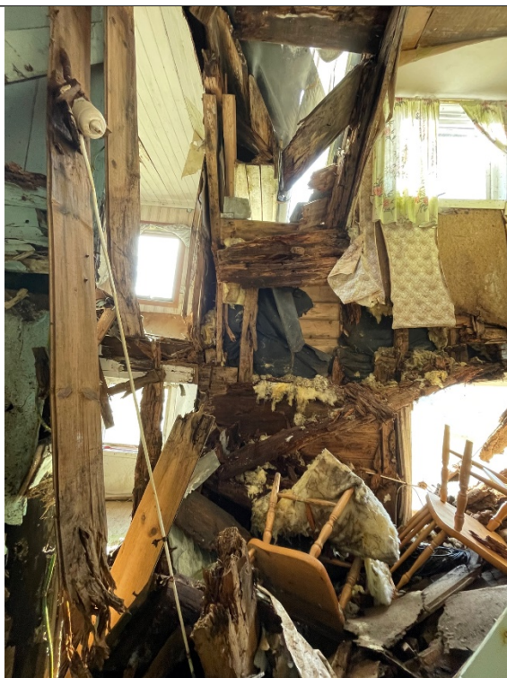
Stue nord – sett mot vest. Foto viser sikt mot 2 vinduer til venstre. Det er kjøkkenvindu og vinduet over – begge mot vest. De kan sees fordi både vegg mot kjøkken, og gulv mot 2.etg. er råtnet vekk. 2 vinduer kan også sees over hverandre til høyre, fordi loftsgulvet er falt ned en etasje. Det lyse området mellom vinduene til høyre og til venstre, er hull i råttent tak.
