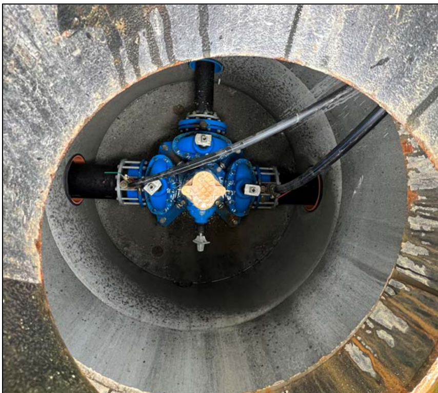
Bilde 1 - Eksisterende brannvannskum SID 44340
