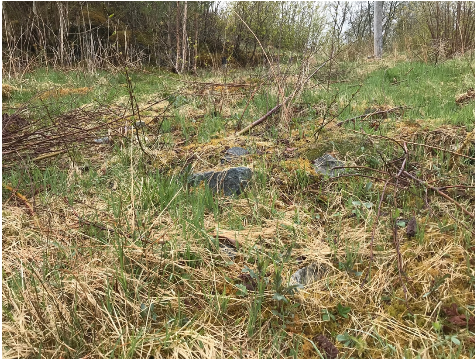
Bilde nr. 2.1. Store steiner er brukt til tildekking av grøft ut fra slamtank. Slåtte og beiteområde er ødelagt. (Grisearbeid)
