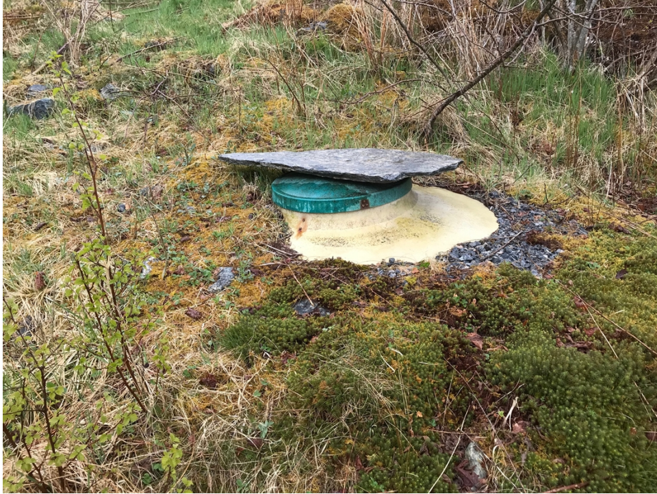
Bilde nr. 4. Slamtank er godt synlig i terrenget uten tildekking. Lokket er ikke tilstrekkelig sikret enda jeg har gitt beskjed om dette både muntlig og skriftlig. Elendig eller ingen sikkerhetskultur.
