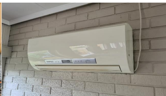
Bilde 9 – Varmepumpe, innedel.
