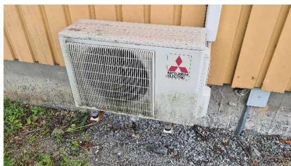
Bilde 8 – Varmepumpe, utedel.
