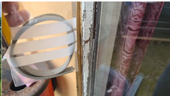
Bilde 4 – Prøvetaking av tettelist i fastvindu.
