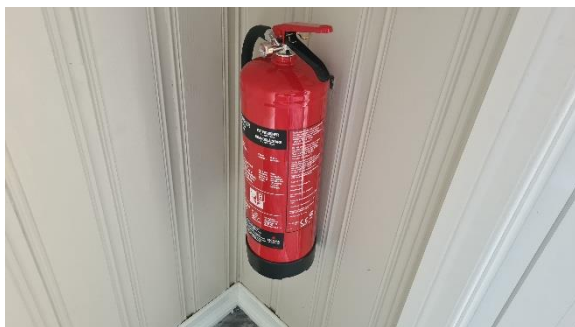
Bilde 12 – Håndholdt brannslukker i garderobe.
