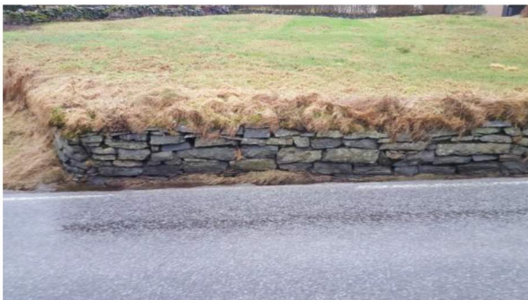
Figur 3-13: Bilde tatt mot nord. Viser resterende del av mur mot synkende veipel nr.
