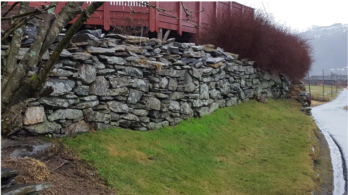
Figur 3-3: Bildet er tatt i retning mot Frekhaug senter og viser tydelig deformasjon i deler av murene.
