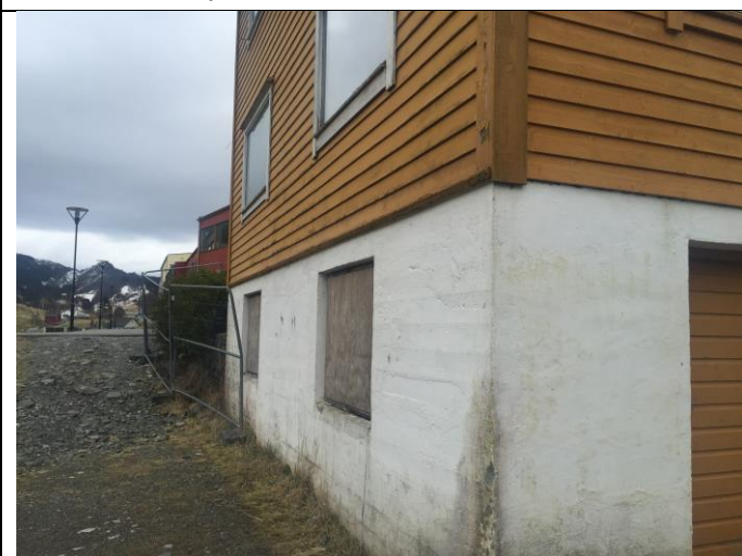
Vinduer er tettet med plater for å hindre uvedkommende
