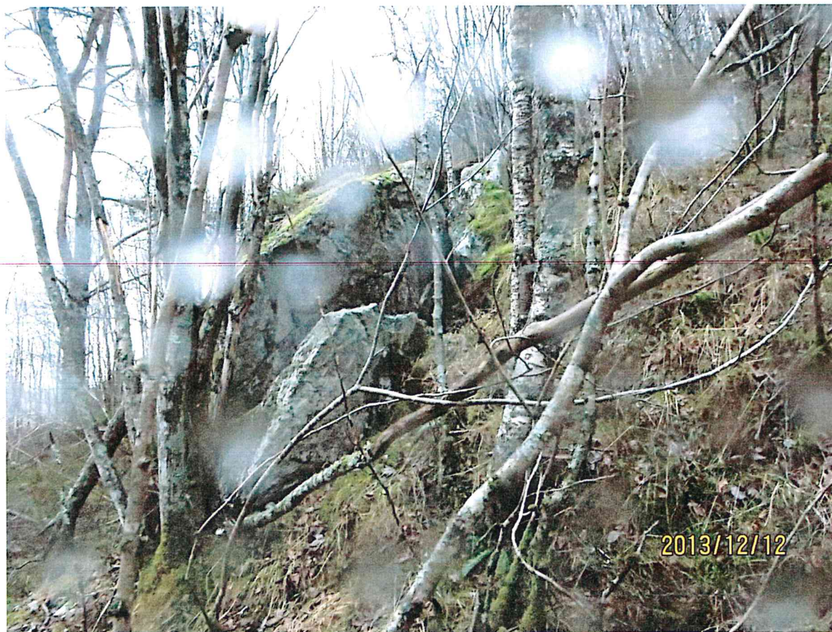
Figur 8. Løsblokker på berg nede i skråningen fotografert fra sør.
