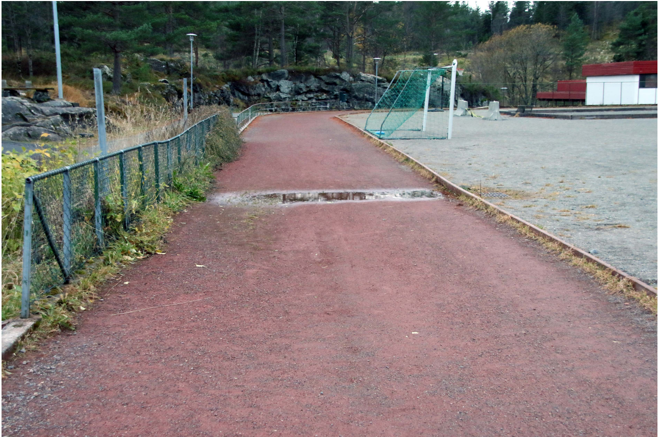
Langsida ned mot ungdomsskulen. Nedsigen om lag midt på. Drenering dårleg.
