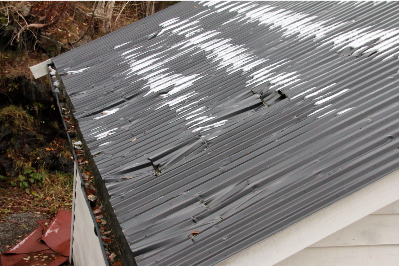
Steinkasting har påført taket på utstyrbygget diverse hol.
