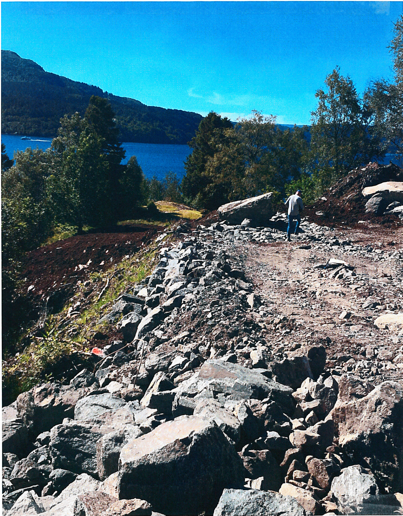
Bilde 2. 30.06.17. Sørøstre, midterste del av tomt. Her skal fjernes noe storstein og påfylles jord.
