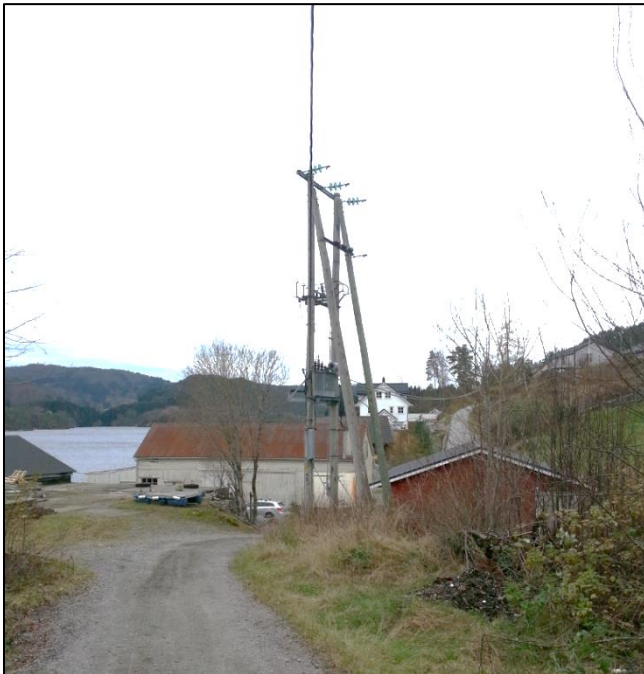
Figur 20: Mastetrafo i området.
