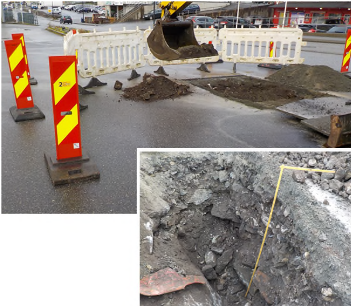
Figur 3. Sjakting i punkt 34. Sjakt P34 ble 1,5 m dyp. Graving avsluttet grunnet store stein og fare for utrasing/setninger på P-plass.
