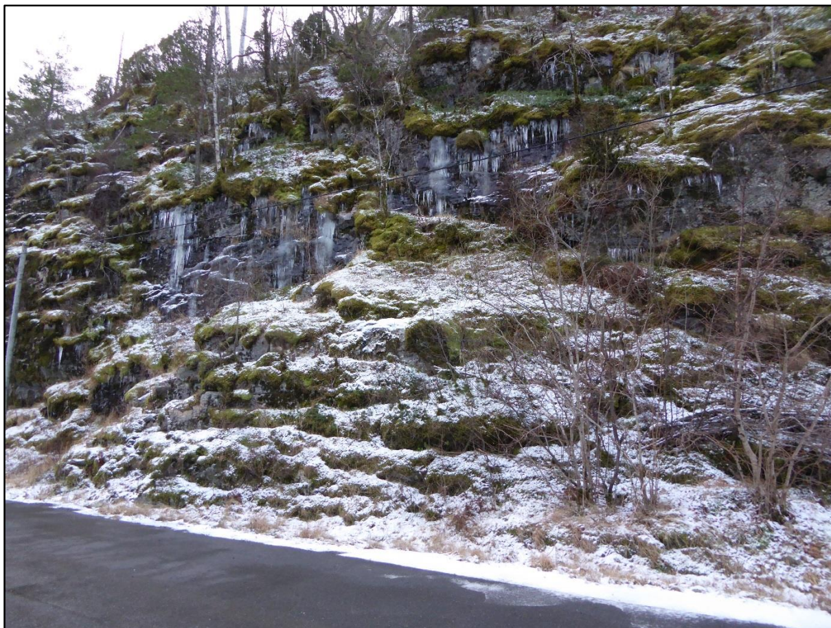
Figur 15: Eksisterende skjæring mellom profil 1180 og profil 1260. Utstikkende parti antas å kunne sprenges/pigges for å få plass til gang- og sykkelveg.
