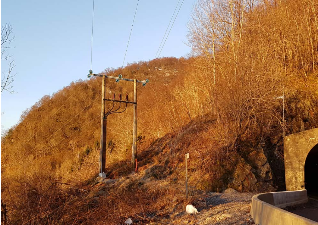
Figur 7.4.1: Høgspenning ved Mundalsbergtunnelen (Foto: Statens vegvesen, 2018)
