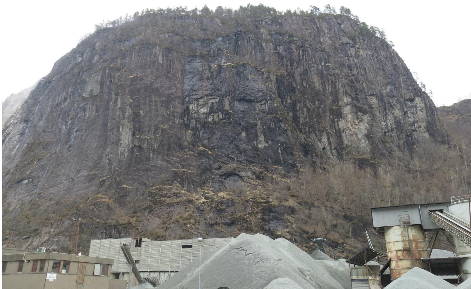
Bilde 8. Sørlige deler av Husafjellet med anleggsplass i fremkant. Enkelte sprekkeavløste bergpartier er observert i fjellsiden.
