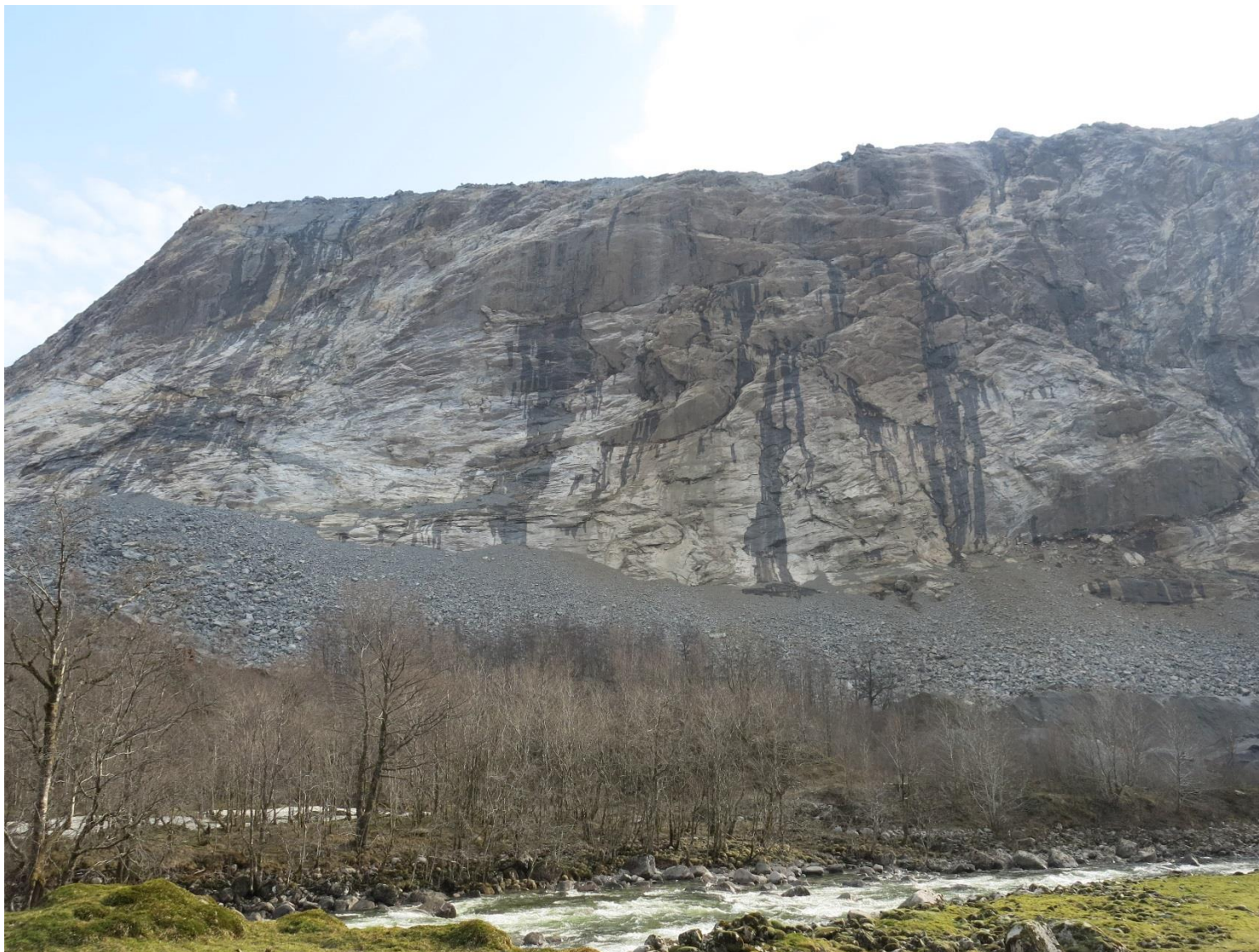
Bilde 1. Storafjellet med blankskurte bergskrenter. Store mengder spengsteinmasser har blitt og blir dumpet ned fra toppen av fjellet og deponert langs foten av fjellet. Det er observert enkelte sprekeavløste bergpartier i deler av dette fjellpartiet.
