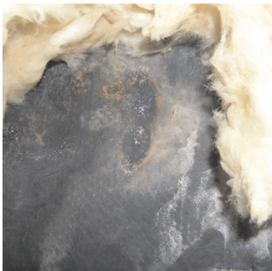
Actinomyceter på forhudningspapp i en utlektet kjellervegg
