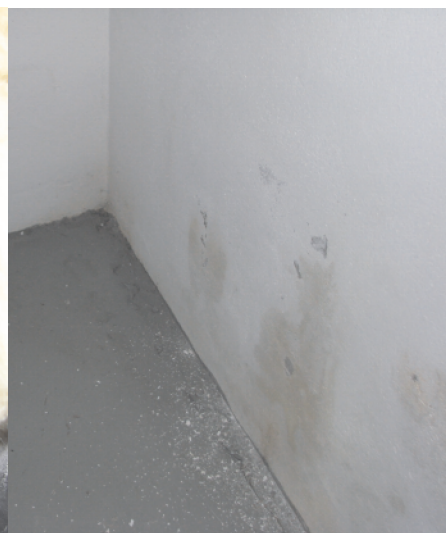
Actinomyceter vokser ofte på fuktbelastede betongoverflater.
