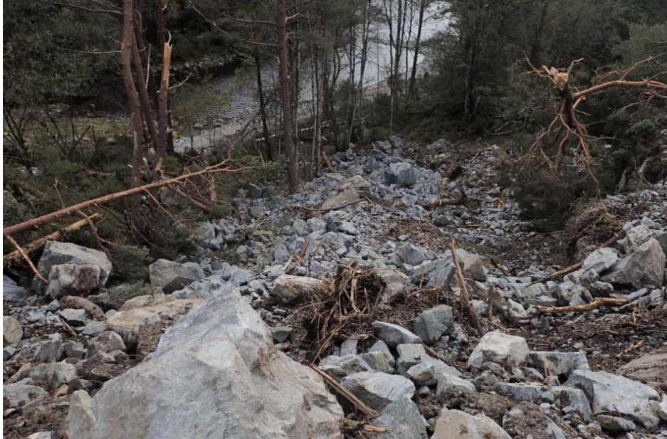
Figur 16: Sprengstein som har rast ut fra veibygging Arbeidet med bygging av kabelgrøft var godt i gang (figur 17).
