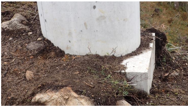
Figur 12: Ufullstendig istandsetting på M43.
