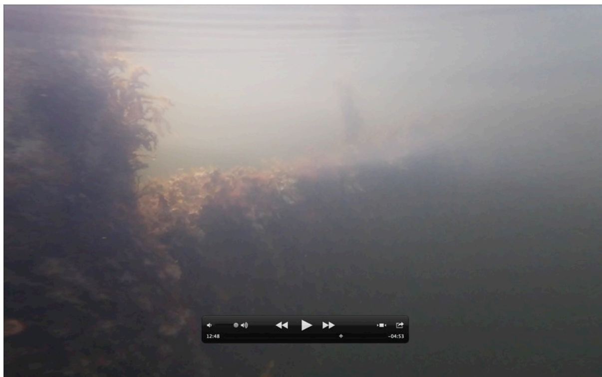
Bilde 21. Vegg ved F, sett mot G. Undervannsbjelke!
