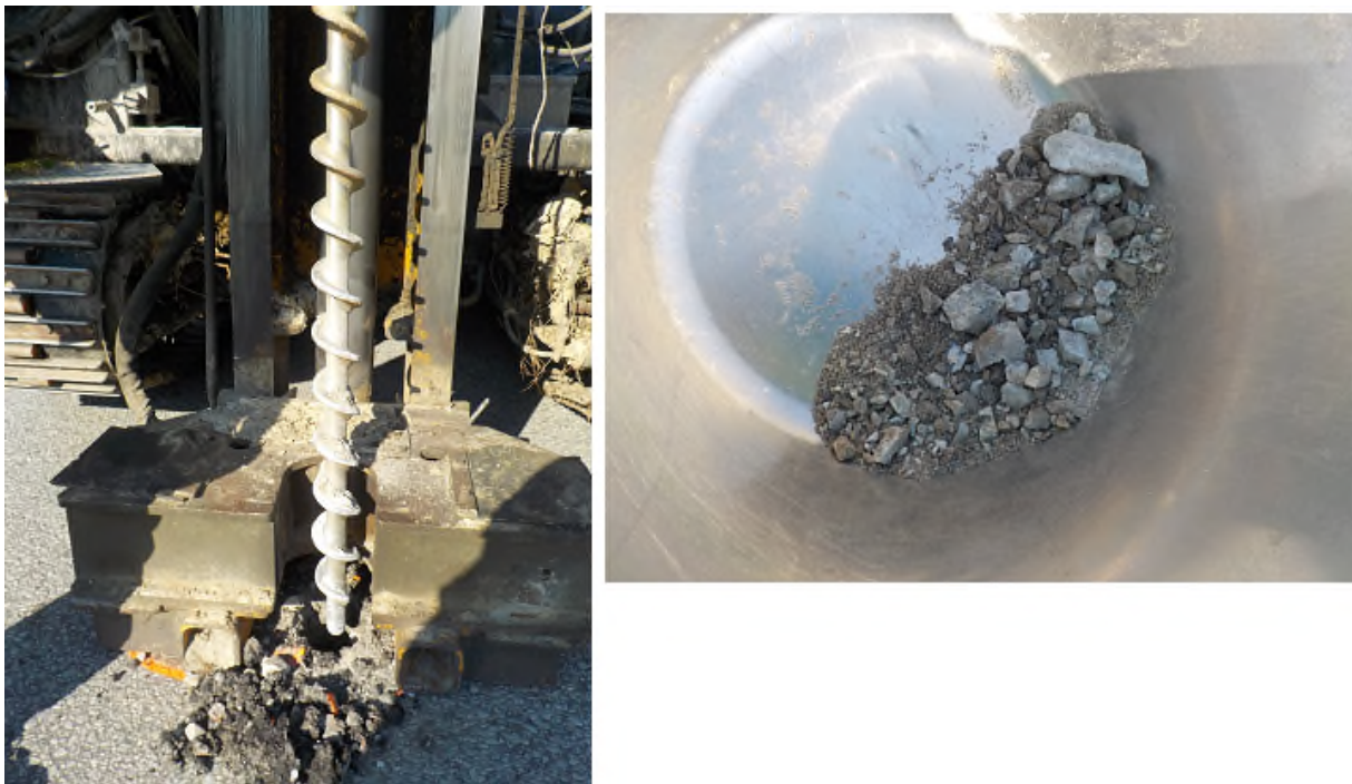
Figur 4. Sjaktning i punkt 41. Sjakt P41 ble 1,5 m dyp. Boring avsluttet mot antatt fjell.
