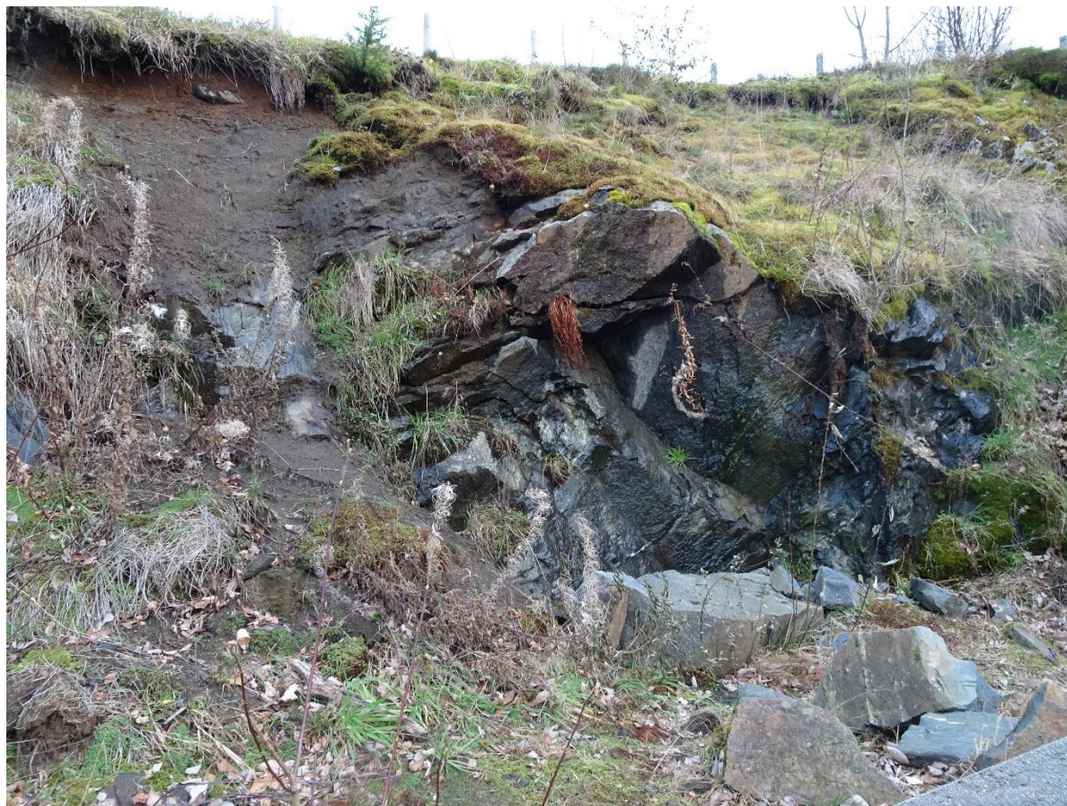
Figur 6. Skjæring ved kunstgressbanen. Berget er oppsprukket og det har falt ned en del stein.
