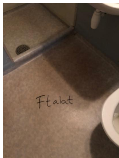
Gulvbelegg merket ftalater
