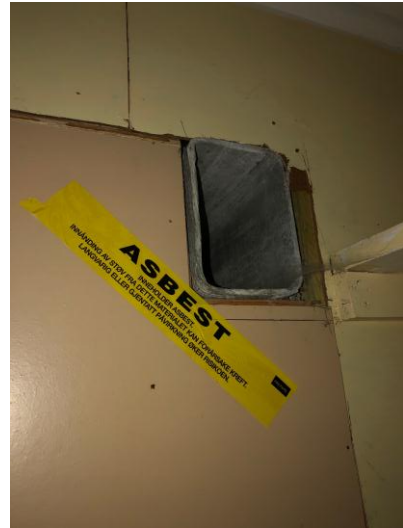
Ventilasjonskanal inneholder asbest
