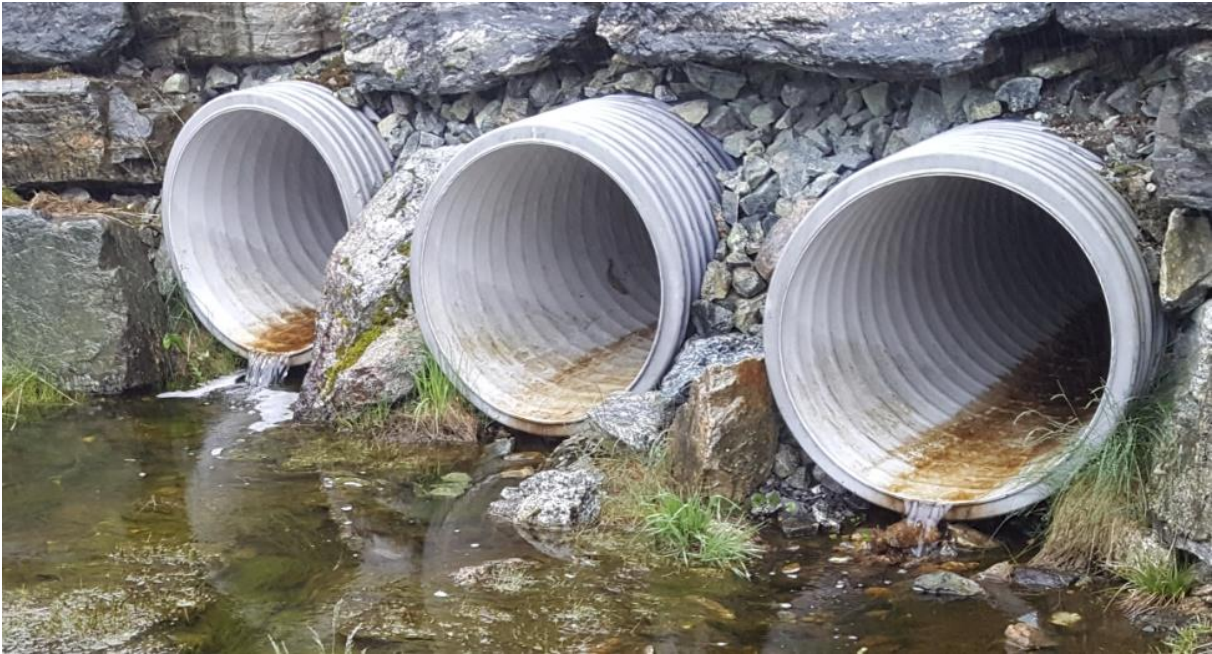
Figur 3: Kulverten under Lonsvegen ligger for høyt i terrenget på nedstrøms side, noe som byr på utfordringer for oppvandrende fisk på små og middels store vannføringer.
