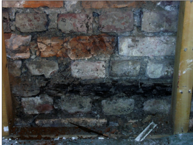
Saltsprengning av teglsteinmur.
