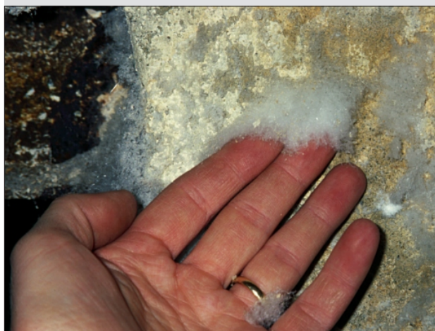
Saltkrystaller på murvegg.
