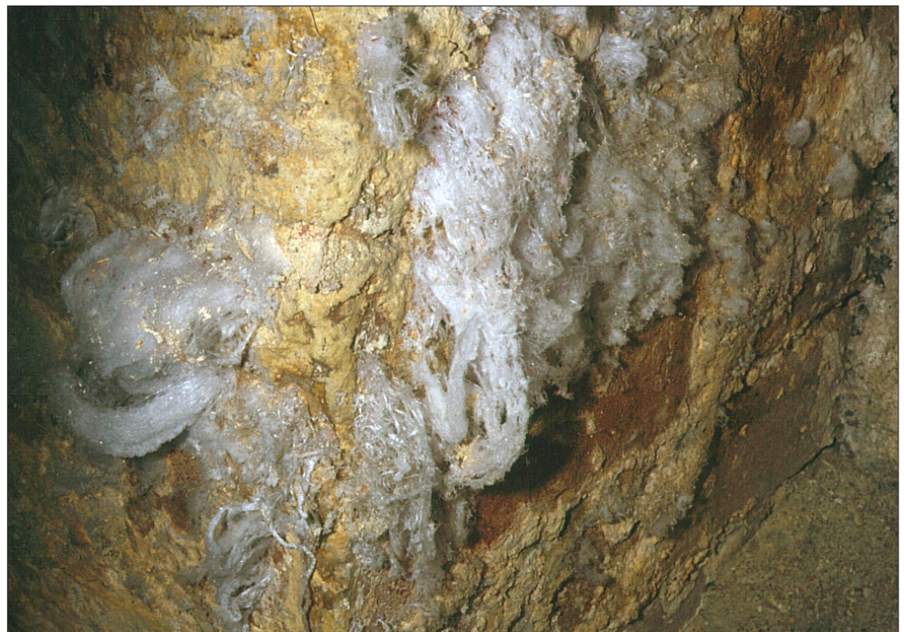
Saltutslag på murvegg.
