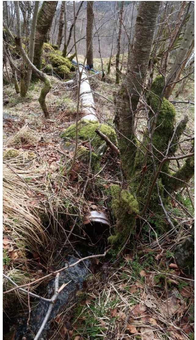
Figur 4 Avløpsrøyr som vart lagt ned av tidlegare eigar.
