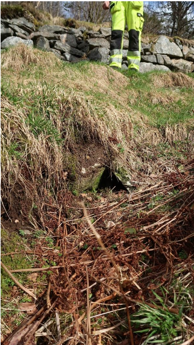
Figur 3 Utløp av gamle stikkrenna på tomta
